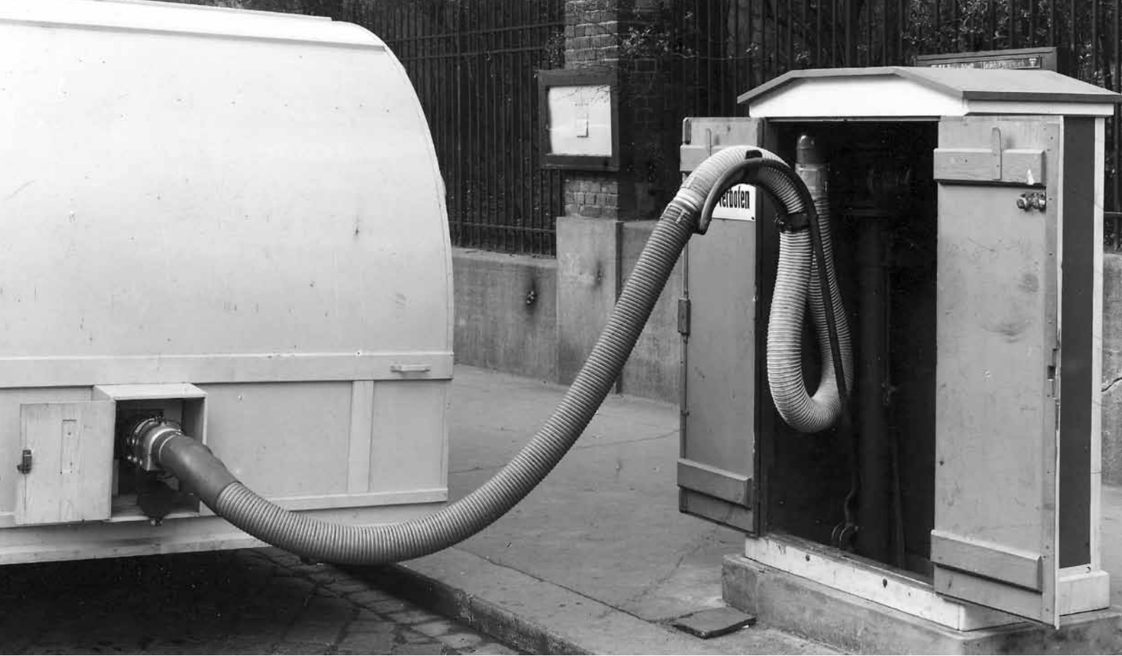
Foto: Archiv Wien Energie Gasnetz
